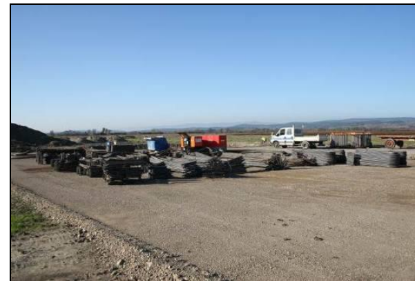
Photo 10 : Stockage des ferrailles
